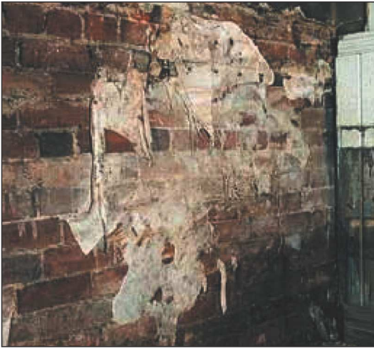
Rys. 4.3.4/1. Grzybnia grzyba domowego właściwego z widocznymi sznurami
