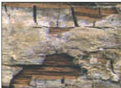
Rys. 4.3.4/3. Rozkład pryzmatyczny drewna spowodowany przez grzyb domowy właściwy
