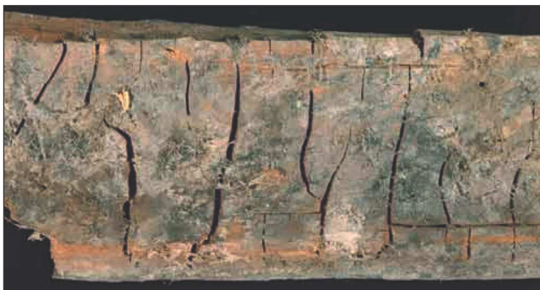
Rys.4.3.4/4. Rozkład pryzmatyczny drewna spowodowany przez grzyb domowy właściwy
